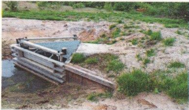
De stuwbakken zijn op drie palen bevestigd. Doordat achter de stuw de grond tussen de damwanden vlak is gemaakt, is de stuw rondom overstroombaar. Foto: Waterschap Reest en Wieden
